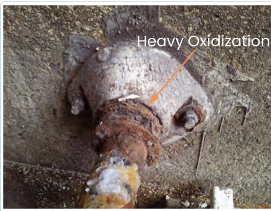
Metalowe łożysko ścienne skorodowane do tego stopnia, że wał jest zablokowany.
